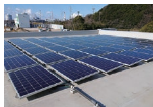
LCCOCの太陽光発電設備
