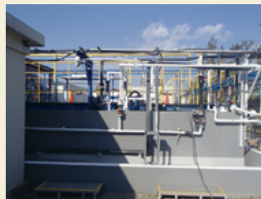
明石工場の排水処理施設
