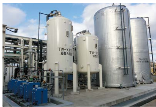
新排水リサイクル設備
