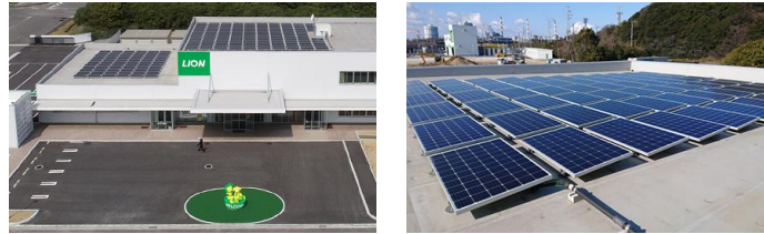
LCCOCの太陽光発電設備
