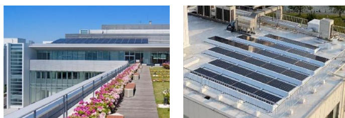
平井事業所の太陽光発電設備
