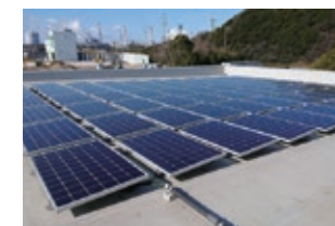
LCCOCの太陽光発電設備
