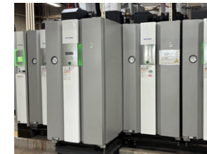
小田原・大阪工場 高効率ボイラー
